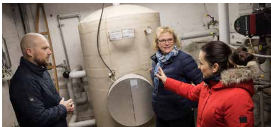
De mange energiforbedringer i A/B Util har allerede nu gjort, at andelshaverne får penge tilbage på varmeregnskabet. Her er foreningens varmecentral.
