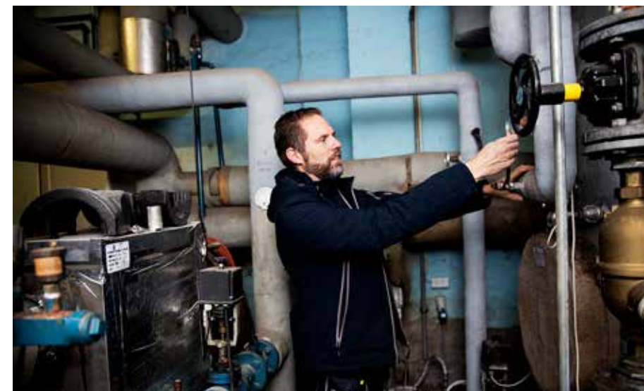
Varmemester Henriks viden har været uvurderlig i foreningens miljøprojekter.
